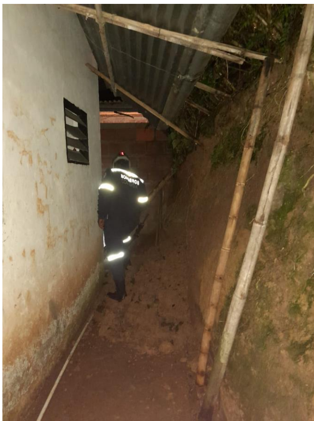
Figura 14. Fotografía de vivienda en zona de riesgo por deslizamiento barrio Bello.
