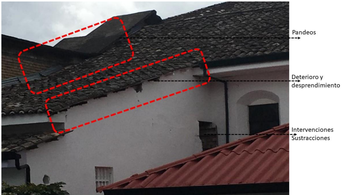
Figura 19. Deterioro de cubierta área colindante con la iglesia de San Agustín.
