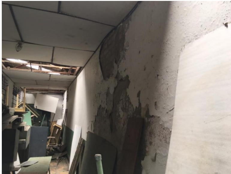
Figura 25. Muros en deterioro.
