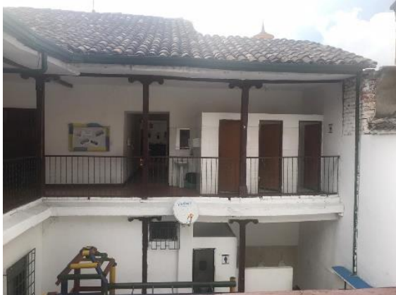
Pandeos en cubierta y entrepiso
