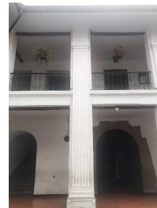
Grietas y pandeos
