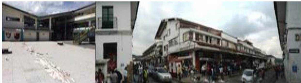
Figura 5. Centro Comercial Anarkos Plaza (Manzana 99), que actualmente presenta fallas estructurales por modificaciones en ausencia de planificación y control.
