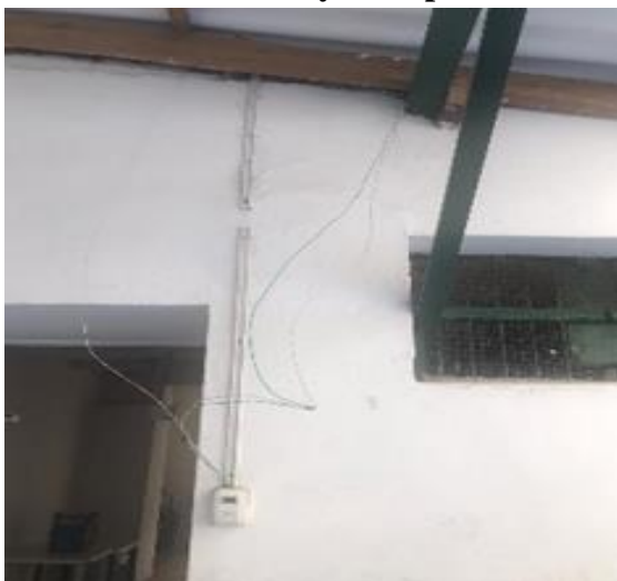
Instalaciones eléctricas sin protección
