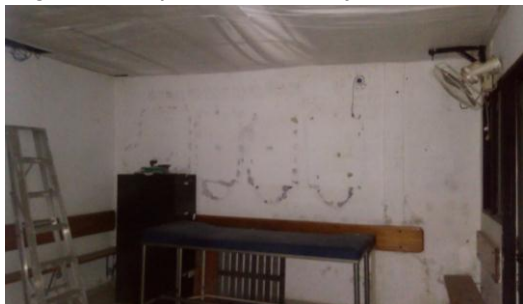
Imagen 64. Espacios sin usar y con humedad
