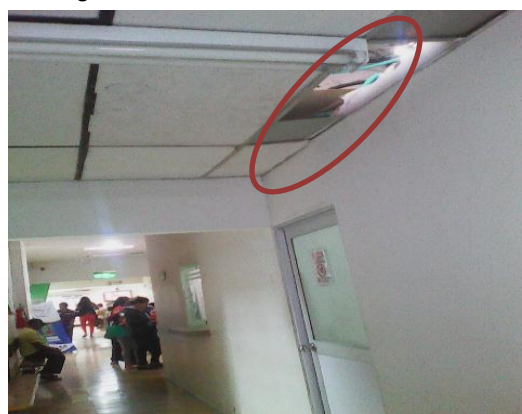
Imagen 5: Daños, área consulta externa
