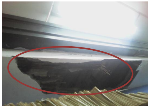
Imagen 8. Daños en Archivo.
