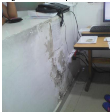
Imagen 67. Daños por humedad
