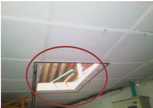
Imagen 7. Daños cerca de dormitorios
