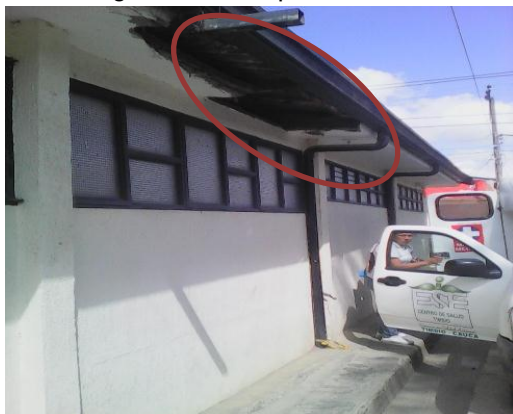
Imagen 4. Daños parte externa
